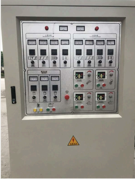
ELEKTRİK KONTROL PANOSU
